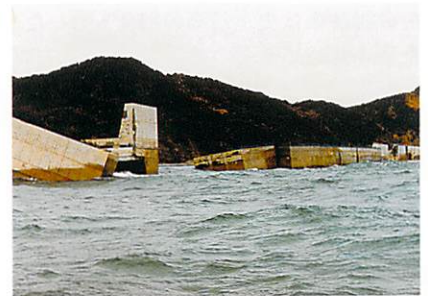
1万トンケーソンの泊地内転落
