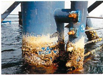
ジャケットの劣化が著しい
